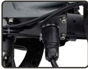
Batería conectada al controlador
