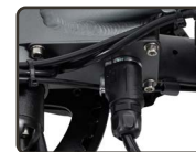
Batteria collegata al controller
